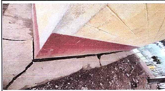
Foto 9: Repello detrás 4 aulas, 50cm de altura.
